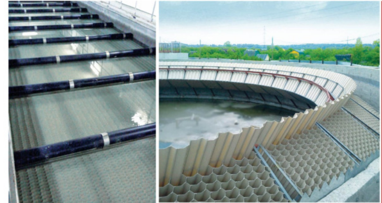
Очистные сооружения водоподготовки
